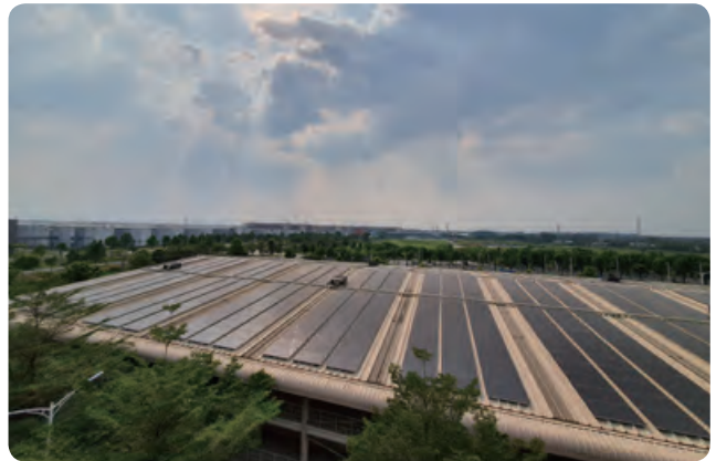
越南廠區的太陽能發電板 PV panels in the Vietnam factory area
